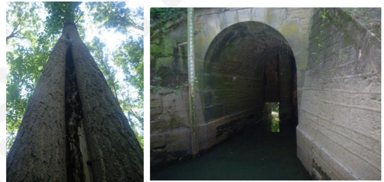
Carie remontante dans un frêne et ouvrage d'art présent au sein de la zone d'étude (Olivier Sousbie)
